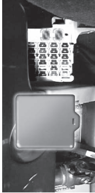
▶ Painel de instrumento do lado do motorista
